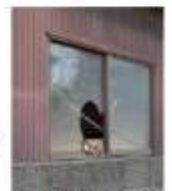
窓が割れた 管理不全空家
