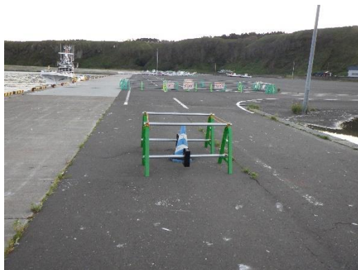
写真① 漁港施設の立入禁止措置状況（落石漁港〈榎室市〉）
