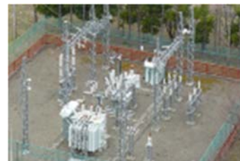
電線路[送電設備] (岩尾内発電所)
