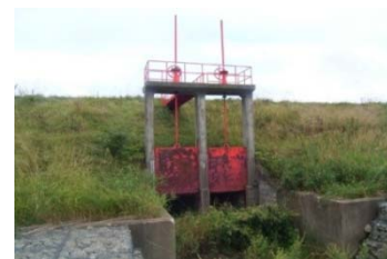
樋門の老朽化状況 (扉体の塗装劣化)
