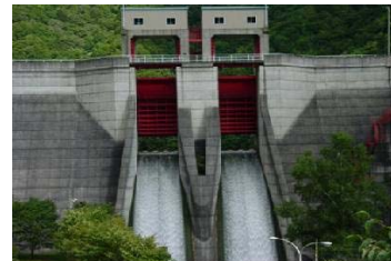
放流設備(ゲート)
