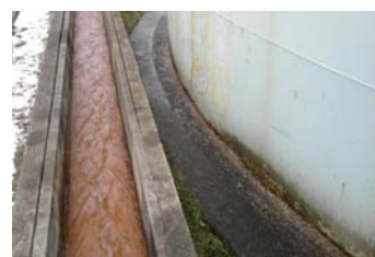
沈降分離槽の老朽化状況
