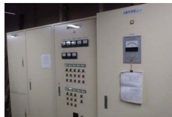
電気設備等 (神居尻地区)
