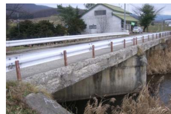
橋梁の老朽化状況
