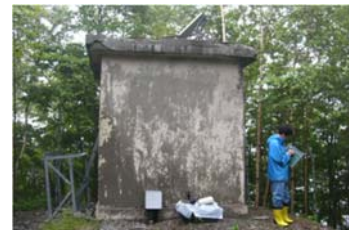
警報局舎の老朽化状況
