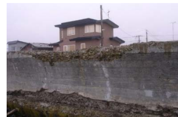
海岸護岸の老朽化状況
