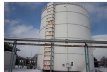
ガスホルダーの老朽化状況
