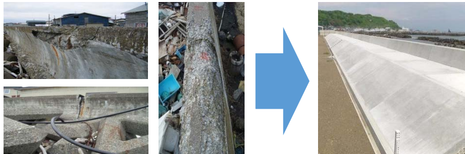
海岸護岸の老朽化対策
