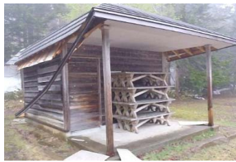
小屋の老朽化状況
