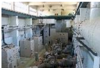
ポンプ設備 (苫小牧地区工業用水道)
