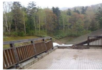
屋上柵の老朽化状況
