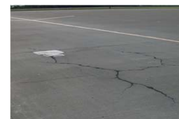
エプロン劣化状況
