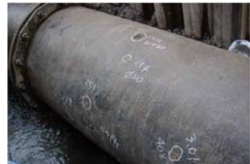
配水管 (室蘭地区工業用水道)
