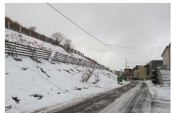
雪崩防止施設 予防柵工 (留萌見晴地区、留萌市)
