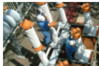
定期点検(送電機器)
