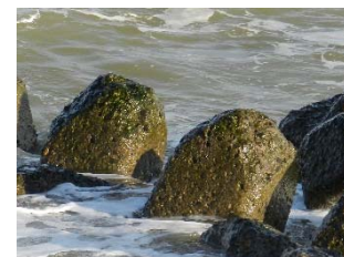
消波ブロックの摩耗状況
