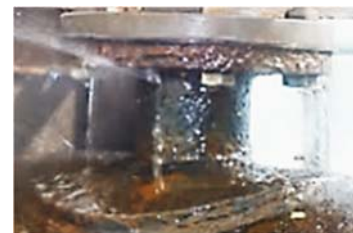
配水管の老朽化状況
