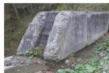
砂防えん堤の老朽化状況
