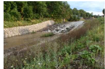
床止め(真駒内川)
