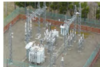
電線路[送電設備] （岩尾内発電所）
