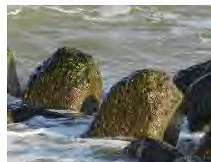
消波ブロックの摩耗状況
