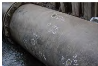
配水管 (室蘭地区工業用水道)
