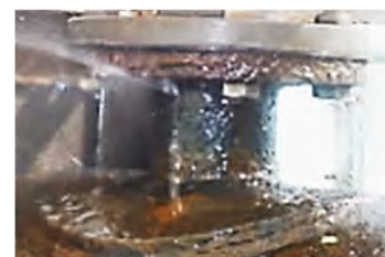
配水管の老朽化状況
