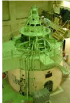
機械[発電機] （鷹泊発電所）
