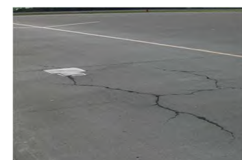
エプロン劣化状況
