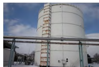
ガスホルダーの老朽化状況
