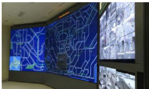
交通管制センター
