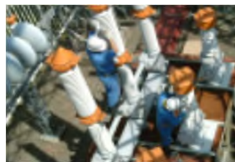
定期点検(送電機器)
