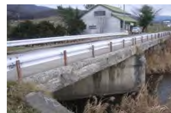
橋梁の老朽化状況
