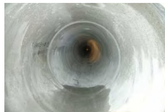
管路 （十勝川流域下水道）
