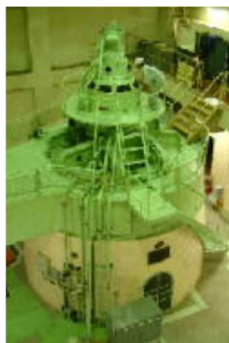
機械[発電機] （鷹泊発電所）
