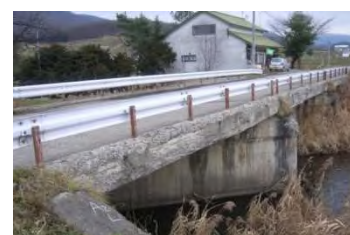
橋梁の老朽化状況
