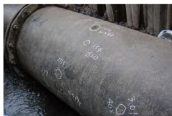
配水管 （室蘭地区工業用水道）
