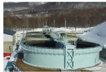
沈降分離槽(幌別硫黄鉱山)
