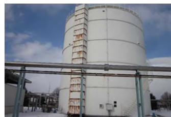
ガスホルダーの老朽化状況
