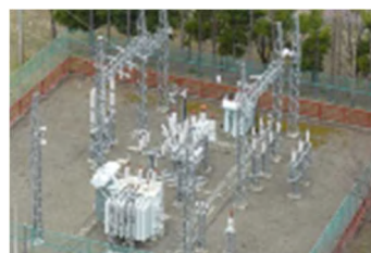
電線路[送電設備] （岩尾内発電所）
