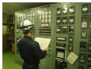
巡視点検(制御装置)
