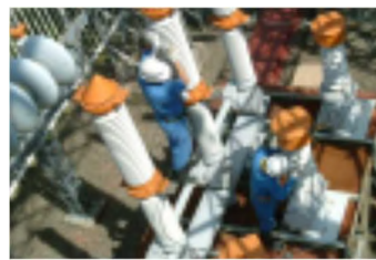
定期点検(送電機器)
