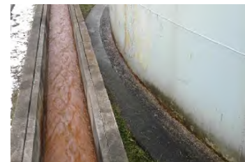
沈降分離槽の老朽化状況
