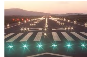
照明施設(紋別空港)
