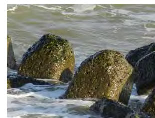
消波ブロックの摩耗状況
