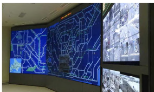
交通管制センター
