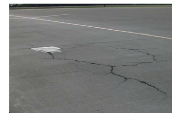
エプロン劣化状況
