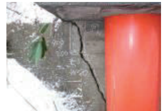
下部工ひび割れ
