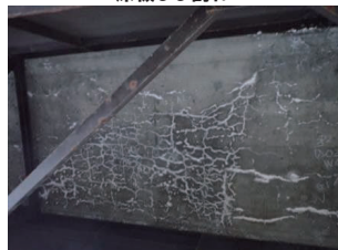
床版ひび割れ
