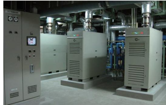
奈井江浄化センターの消化ガス発電設備（石狩川流域下水道）
