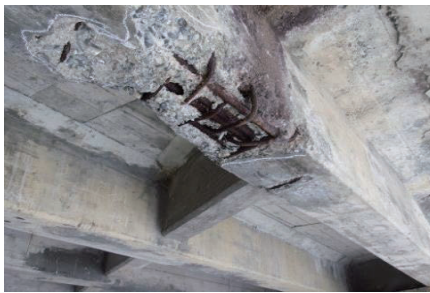
橋梁主桁の劣化
