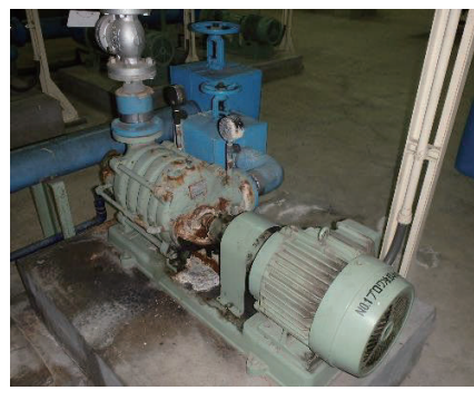
下水道ポンプの老朽化
