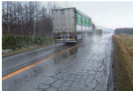
道路の舗装の劣化
