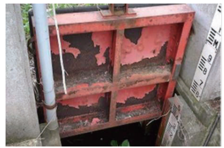
樋門ゲートの腐食
