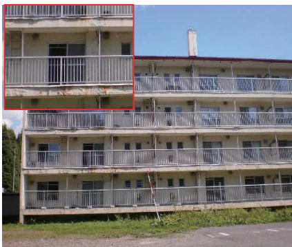
公営住宅の老朽化
