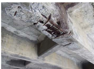
橋梁主桁の劣化
