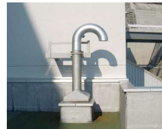
タービン動補助給水ポンプ排気管の対策 （排気管末端を下向きに改造）
