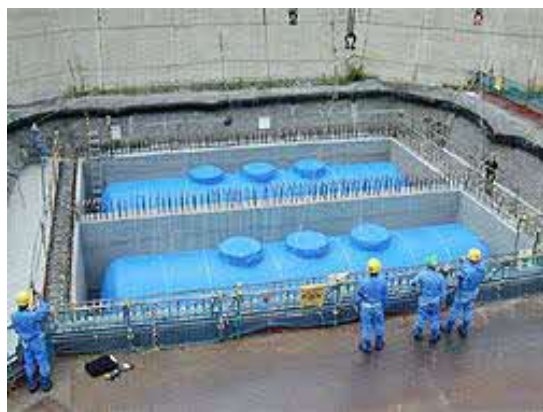
ディーゼル発電機燃料油貯油槽 設置工事時の状況(追加設置)
