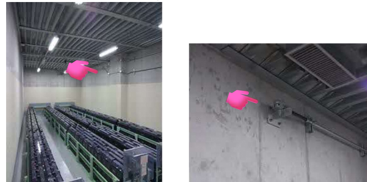
水素対策の例：水素検知器（蓄電池室）
