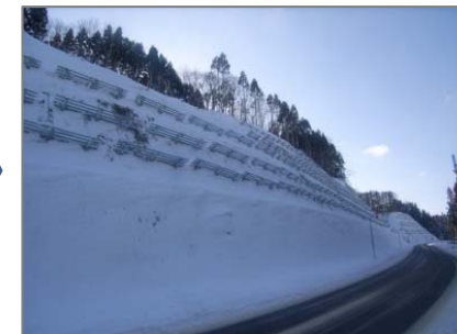
<対策例>雪崩予防柵
