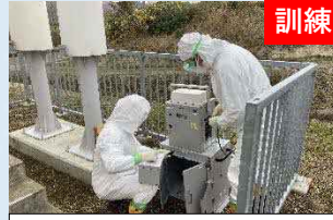
代替測定機器の設置
