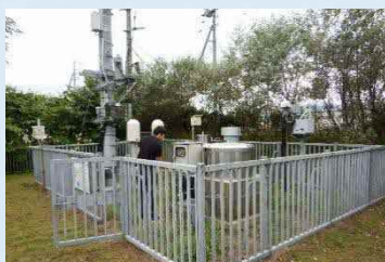
固定局測定機器の点検等
