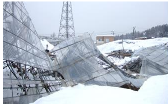
雪の重みでさくらんぼ加温ハウスが全壊し、 さくらんぼ樹体にも被害(寒河江市)
