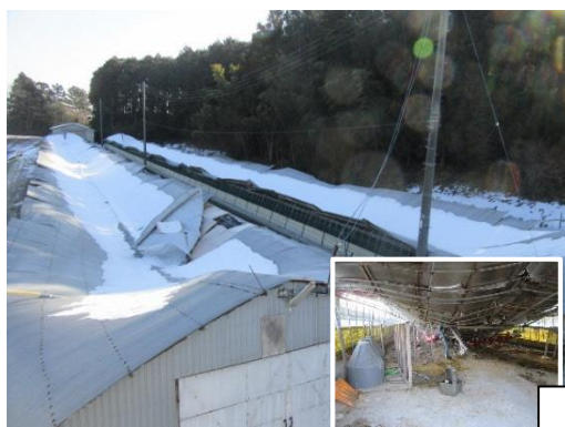
雪の重みで鶏舎が全壊(大崎市)
