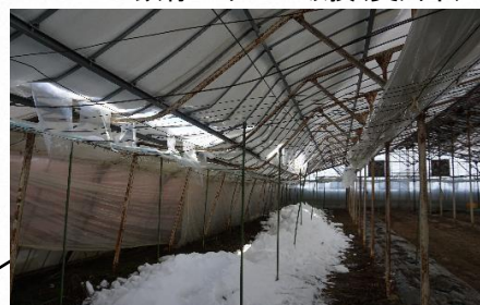
トマト鉄骨ハウスの破損(奥州市)
