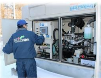
非常用発電の起動
