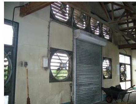
トンネル換気
