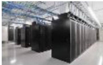
データセンター
