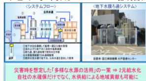
（地下水利用のための設備）
