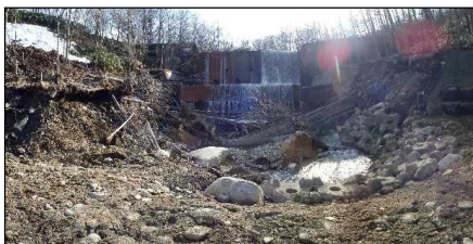
1号堰堤下流荒廃状況
