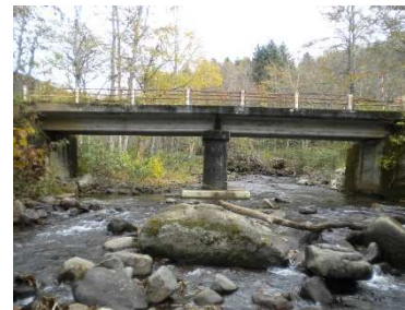
老朽化した橋梁【上川北部】
