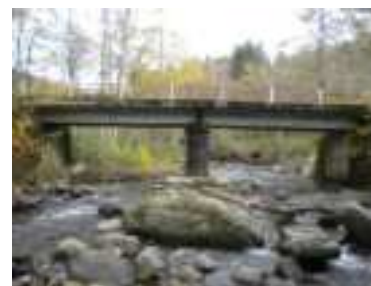
老朽化した橋梁【上川北部】
