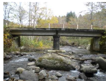
老朽化した橋梁【上川北部】
