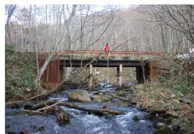
老朽化した橋梁【渡島東部】
