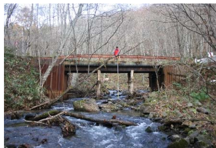
老朽化した橋梁【渡島東部】
