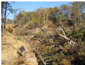
胆振東部地震被災箇所
