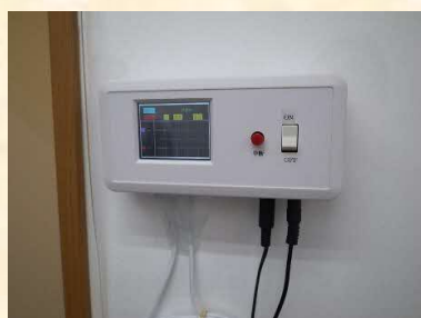
コントロール装置
