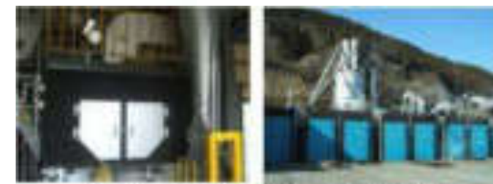
左-木質バイオマスボイラー、右-木材乾燥機
