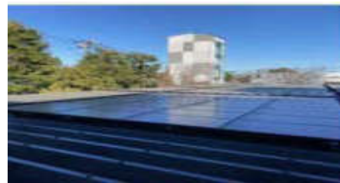
印刷工場の屋根に設置した太陽光発電 (環境省HPより)
