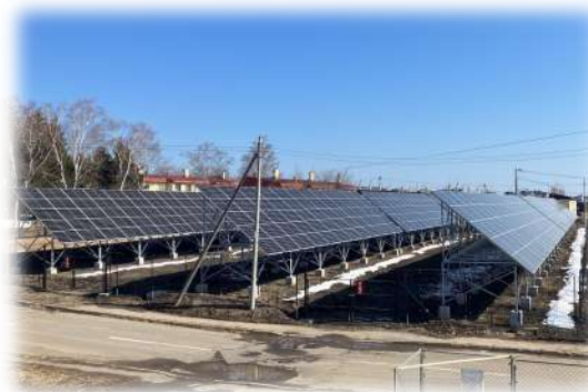
太陽光発電設備
