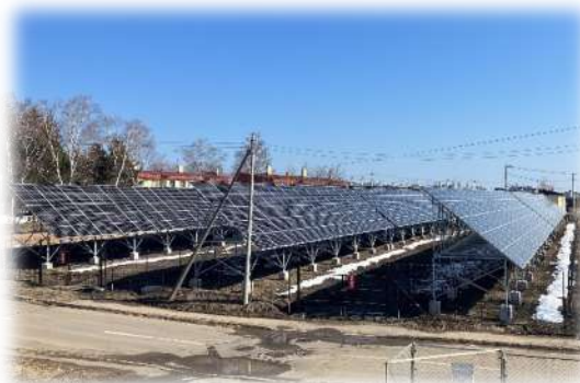
太陽光発電設備
