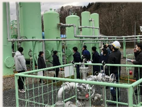
▲ 豊富鉱山（豊富町） 天然ガスのコージェネレーションシステムを導入し、鉱山施設の電力を賄うとともに、廃熱を温泉水の加温に利用し、各宿泊施設に供給しています。
