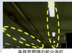
事務室照明の部分消灯
