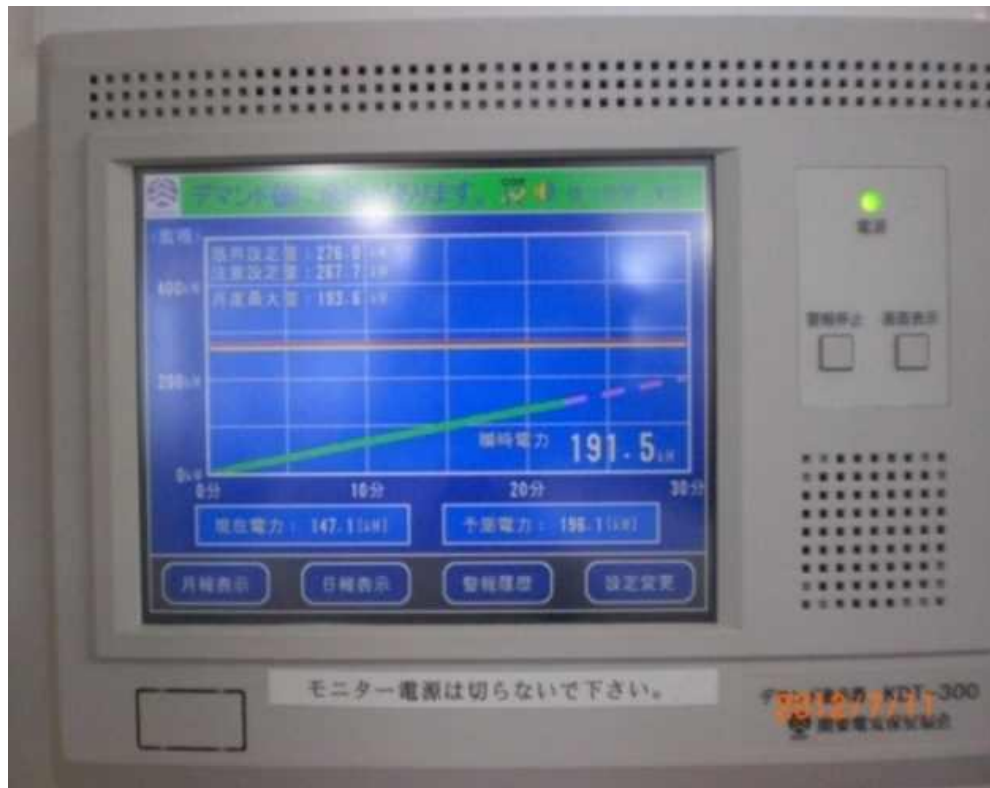
モニタ付きデマンド監視装置の一例
