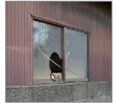
窓が割れた管理不全空家
