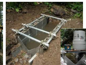
水量計測・水質調査装置
