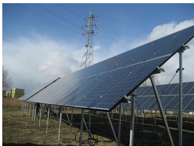
当別町と共同で建設した太陽光発電所
