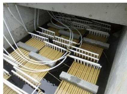
温泉排湯槽での設置状況
