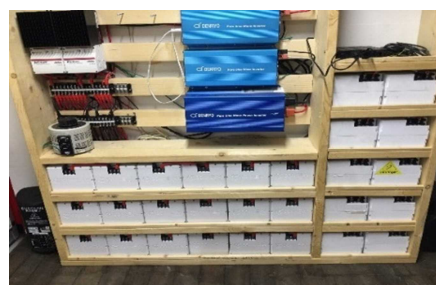
搭載電源／蓄電池システム 30kwh リチウムイオン 合計 4.5kw の出力装置群
