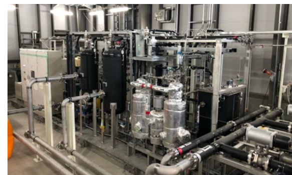
水素製造装置
