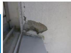
外壁の剥落 (道立北見体育センター)
