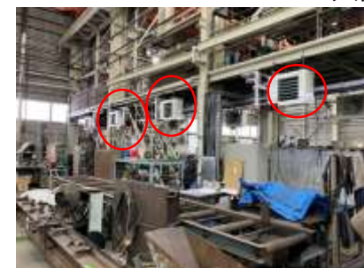
ユニットヒータ(送風器)
