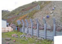
平成24年10月斜面崩壊状況
