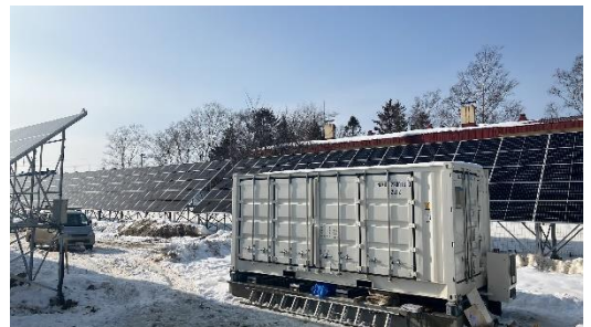
▲太陽光発電設備と大型蓄電設備「NAS®電池」
