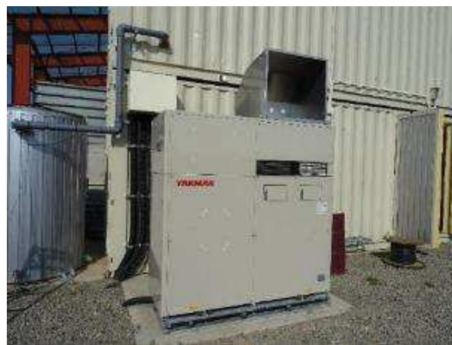
バイオガス発電機(25kW)
