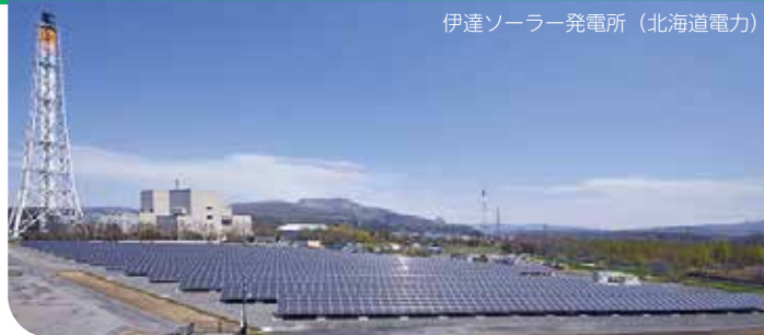
伊達ソーラー発電所（北海道電力）
