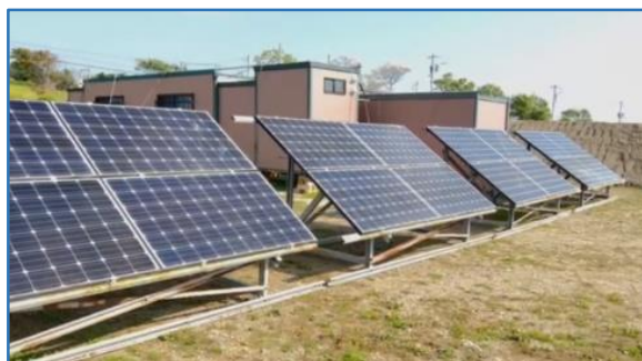
▲現場用の太陽光パネル
