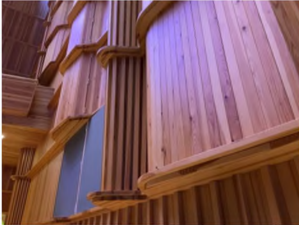
壁面の可動式音響設備
