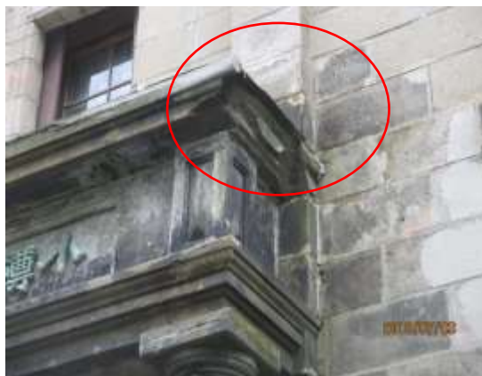
入口庇部分の大きな欠け
