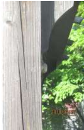
柱・梁の割れが見られる部材
