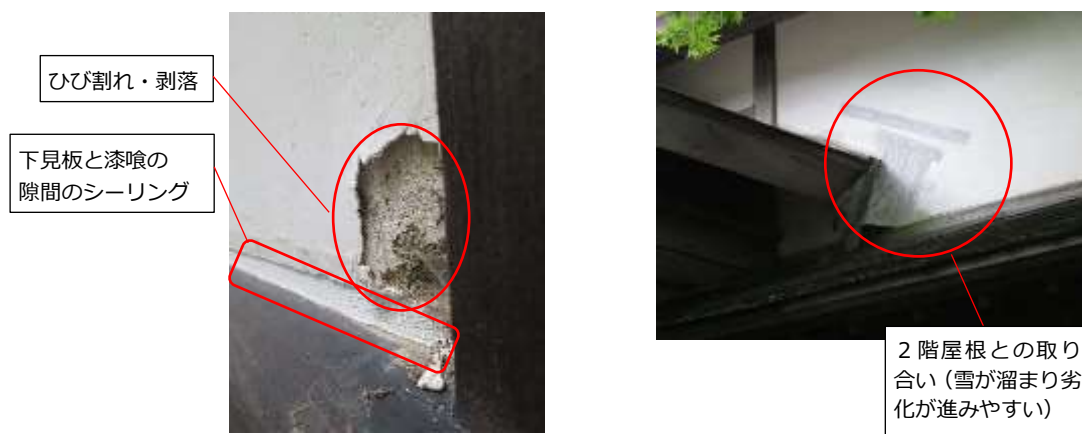
外壁漆喰の損傷箇所
