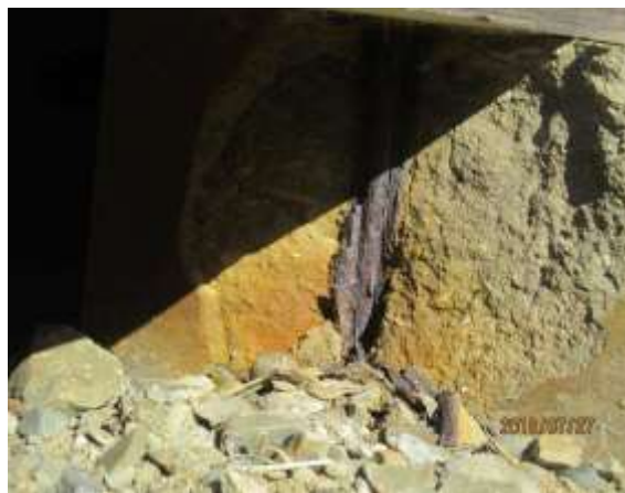
旧近藤染舗束石の爆裂部分
