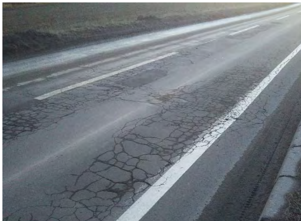
支持力低下によるひび割れ状況
