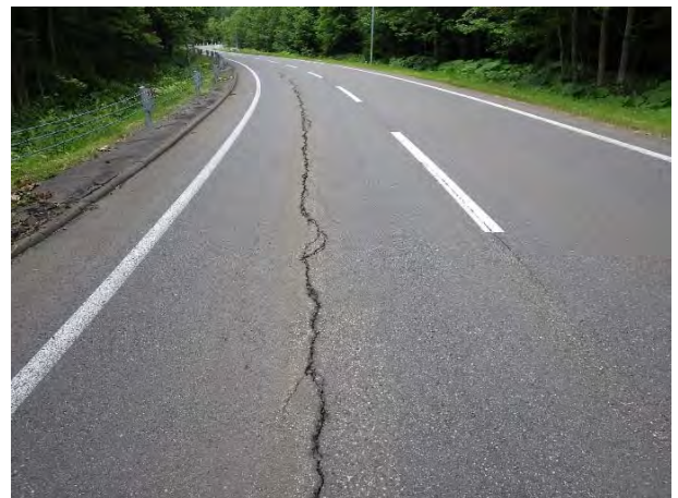
凍上によるひび割れ状況
