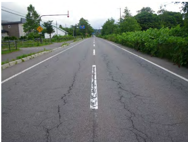
疲労によるひび割れ状況 (両輪の通過部に発生)
