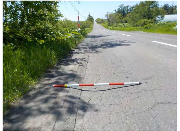
沈下による平坦性の悪化
