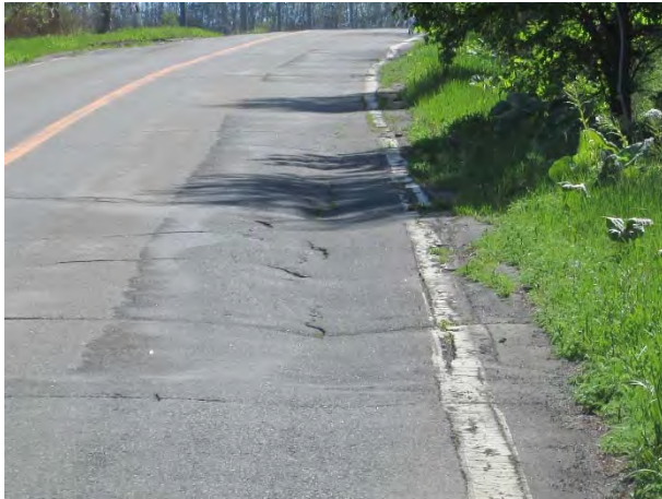
沈下による平坦性の悪化
