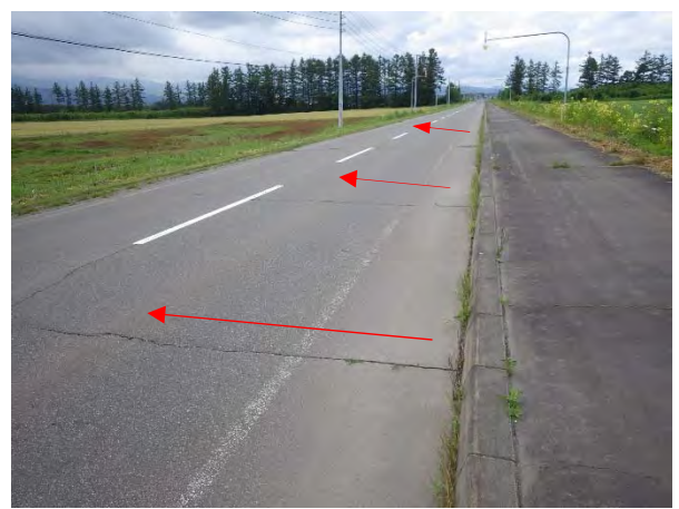
温度応力によるひび割れ状況 (横断方向に発生)
